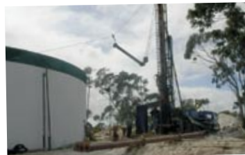
Captação de água no Talefe, na freguesia do Vau
