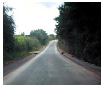
7 - Rua Casal do Pinhão, Bairro Senhora da Luz: Obras de rebaixamento do piso e substituição do coletor de esgoto.
