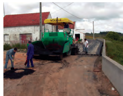
6 - Depois de ter estado inactiva, mais de 12 anos, esta máquina de asfaltamento voltou ao activo. Finalmente!
