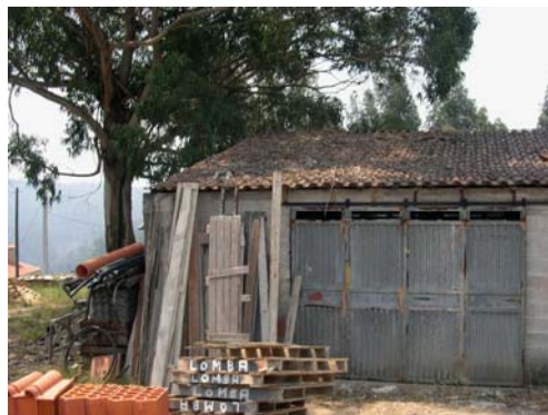
Figura 13 — Acumulação de material combustível junto à edificação.
